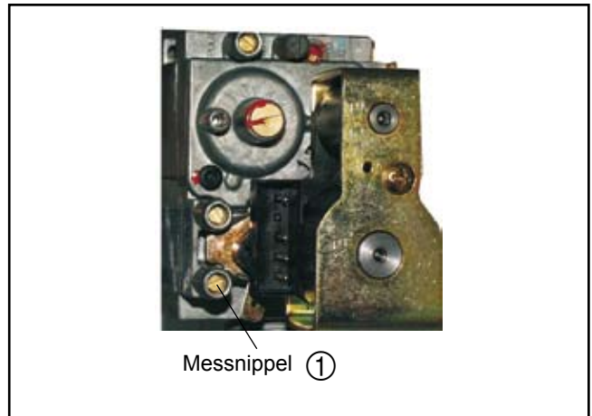
Bild: Überprüfen Gasanschlussdruck
