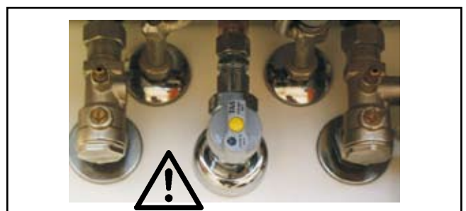
Bild: Gasanschluss: Gefahr von Vergiftung und Explosionsgefahr durch ausströmendes Gas
